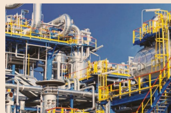
Isolamenti - Impianto di produzione di anidride maleica
